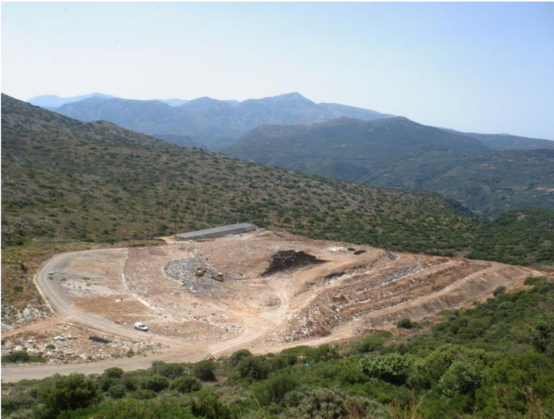
Εικόνα 1: Εγκαταστάσεις Χ.Υ.Τ.Α Χερσονήσου
